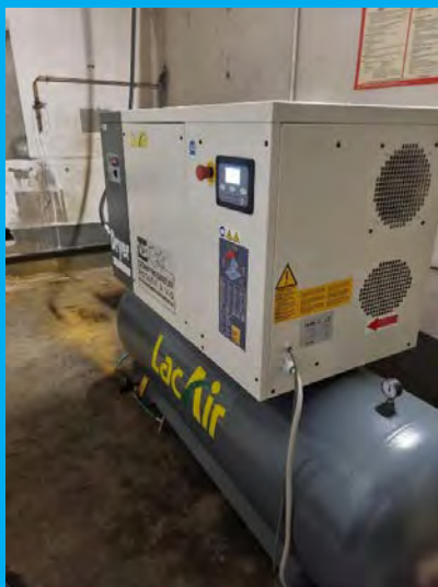
Compresseur central à vis
